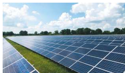
СОНЯЧНА ЕЛЕКТРОСТАНЦІЯ ООО «Сонячна брама» Івано-Франківська обл. 2018
