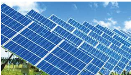
СОНЯЧНА ЕЛЕКТРОСТАНЦІЯ ТОВ «АСК Інжиніринг» Херсонська обл. 2019
