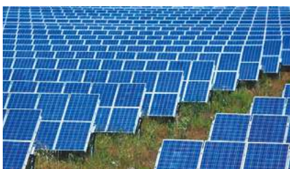
СОНЯЧНА ЕЛЕКТРОСТАНЦІЯ ООО «СОЛАР ЕНЕРЖІ-СКІФ» Вінниця 2019
